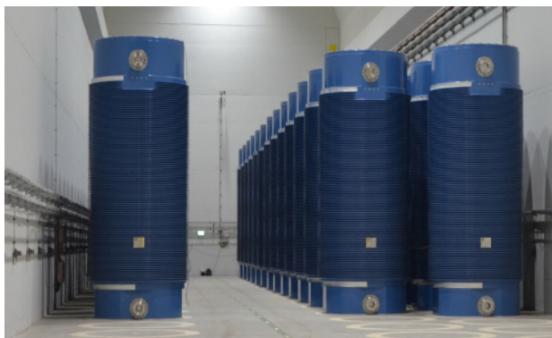
Figure 14 : Vue de l'intérieur de l'entreposage centralisé du site de Gorleben (Allemagne)
