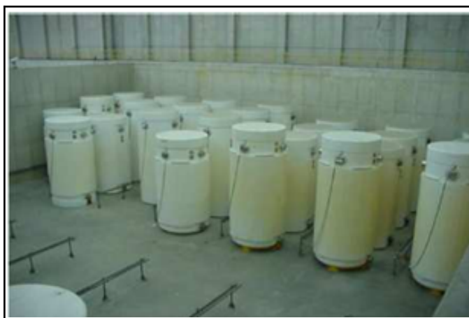
Figure 12 : Vue intérieure des TN®24 dans le bâtiment d'entreposage à sec du site de Doel (Belgique)
