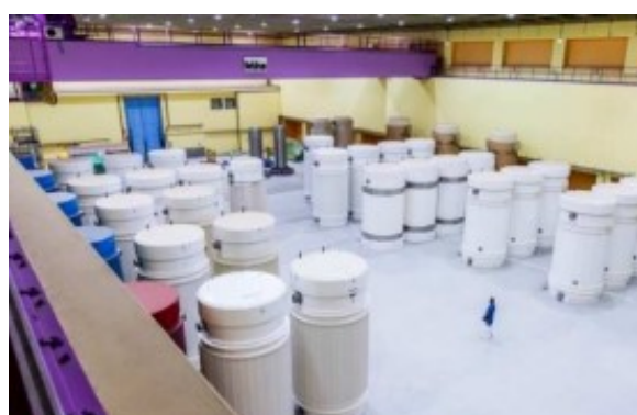
Figure 15 : Vue de l'intérieur de l'entreposage centralisé du site de Zwiilag (Suisse)
