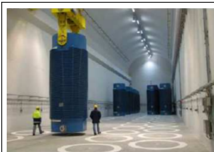
Entreposage à sec de combustible nucléaire usé
