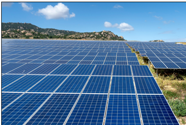
Centrale solaire photovoltaïque
