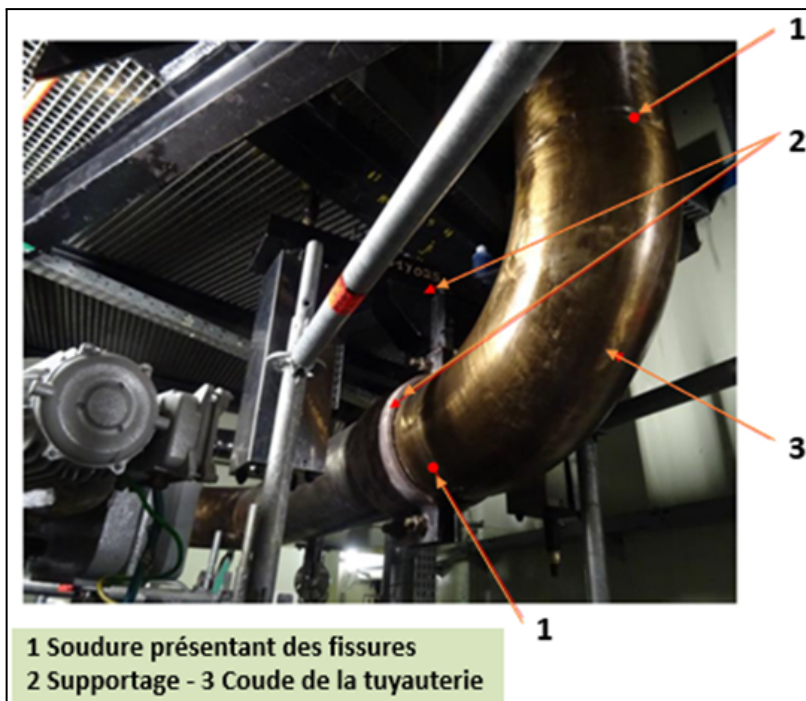
Configuration des tuyauteries affectées par le phénomène de corrosion sous contrainte
