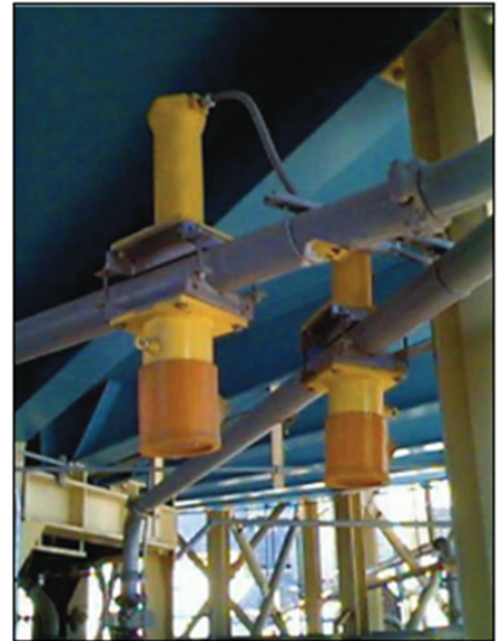
Jauge de mesure de densité en position sur des canalisations Source AIEA →
